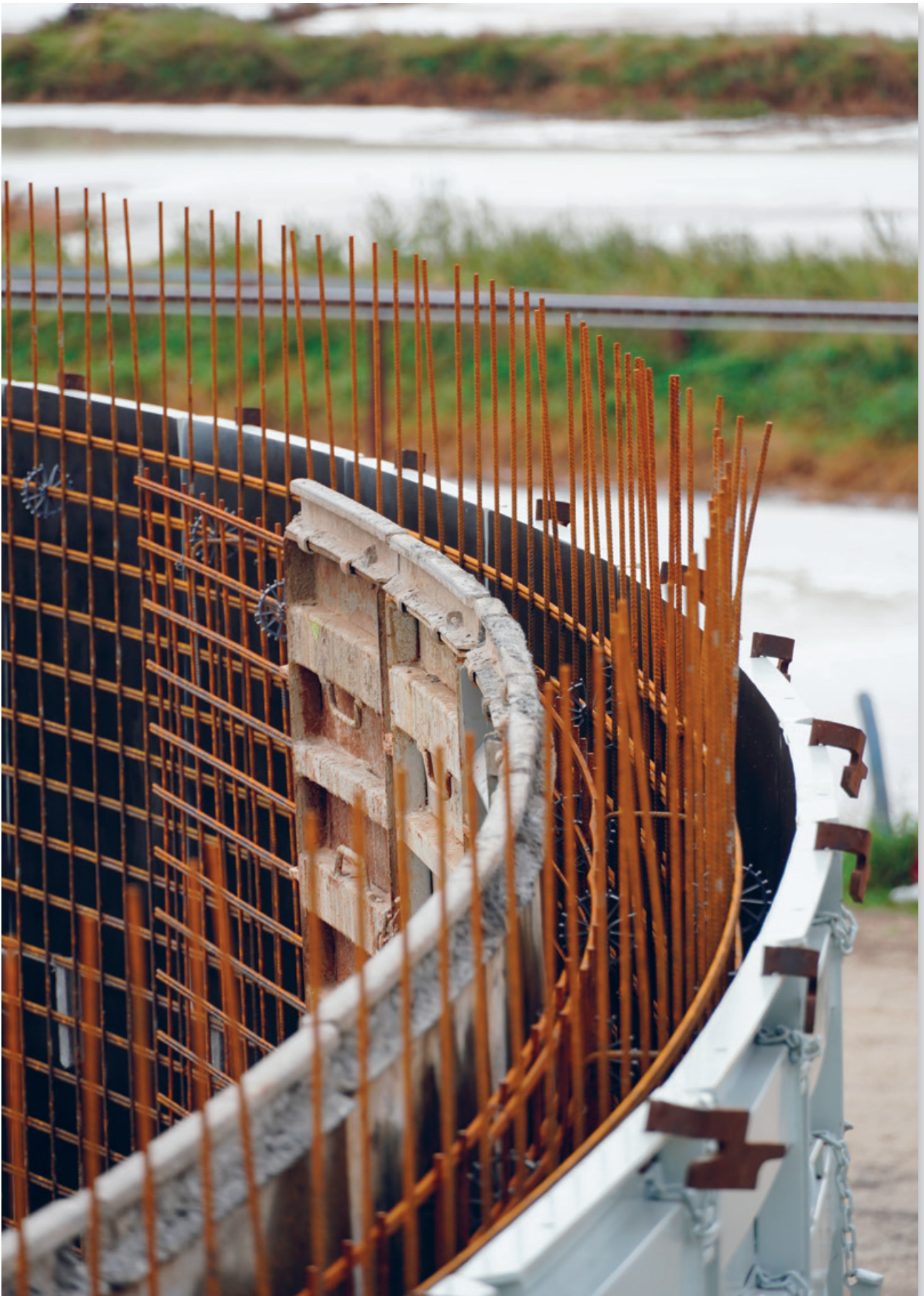
Digesteur, Iscal Sugar (Belgique)
